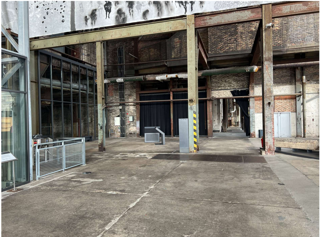
Det är nu 33 år (2023) sedan man stängde ner kraftverket så nu liknar det mer ett rostigt stålskelett.
