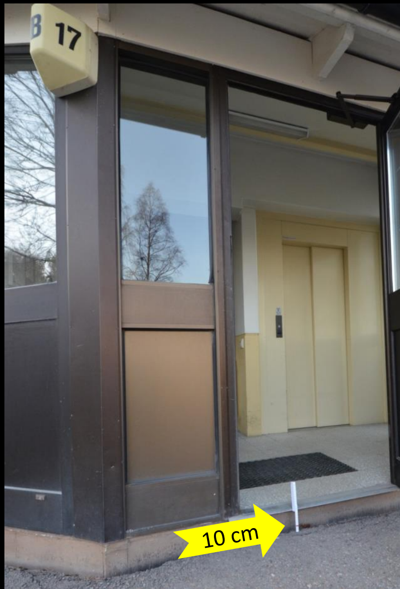
Hiss med entréstep som lätt kan åtgärdas
