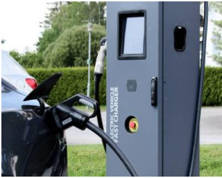
Laddstation för elbil
