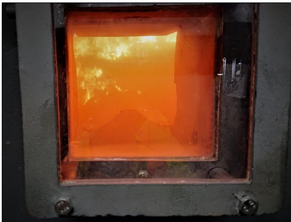
Ett ca 10 x 10 cm stort fönster för inspektion av eldhärden.
